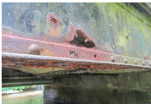
Figure 2 : exemple de corrosion d'une poutre métallique avec pertes de section et perforations (hors champ d'étude de la présente fiche).
