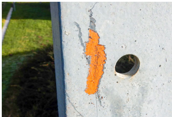
Figure 3 : exemple de la présence de minium de plomb sur une structure en métal.
