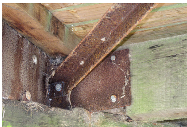
Figure 1 : exemples illustrant une oxydation de surface sur des ponts métalliques.
