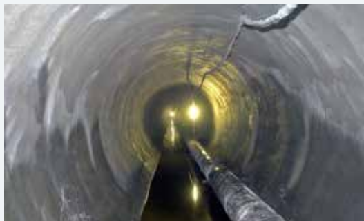
Ouvrage ancien, l'émissaire général permet de transporter les eaux usées parisiennes en direction de Triel-sur-Seine (78). Sa construction date de la fin du XIX e siècle et du début du XX e .
